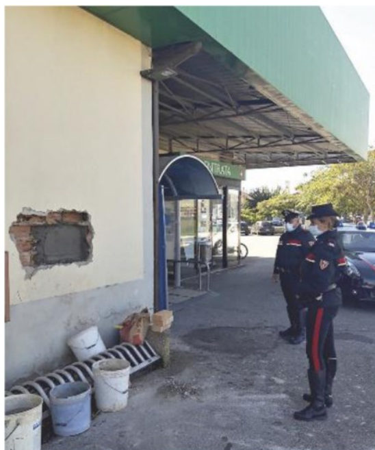
Il muro danneggiato dai malviventi
